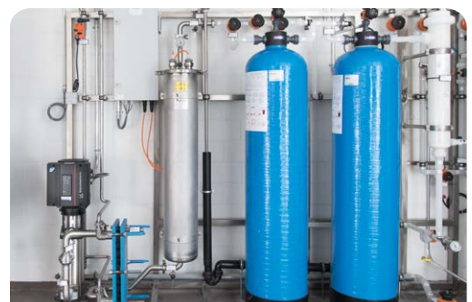
Verteilung mit Druckerhöhung, Wärmetauscher, UV-Anlage, Polisher und Mikrofilter für Ultrapure Water
