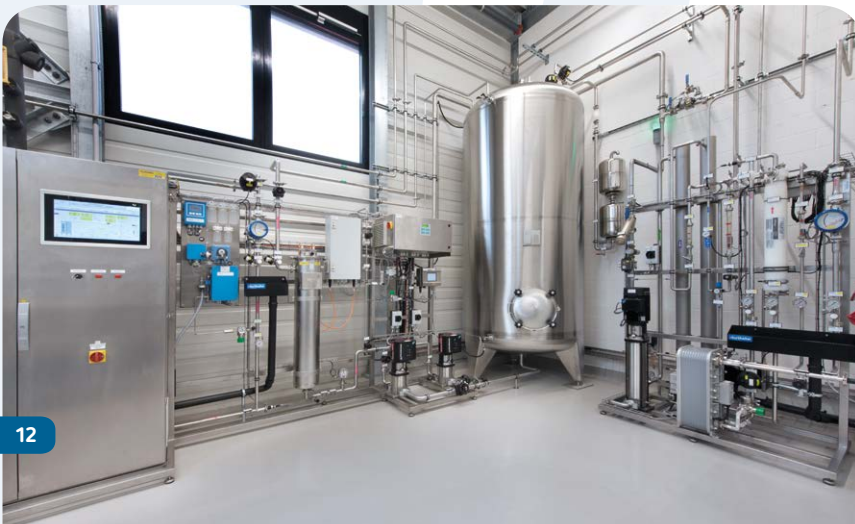
Wasseraufbereitung für höchste Ansprüche in der Pharmaindustrie
